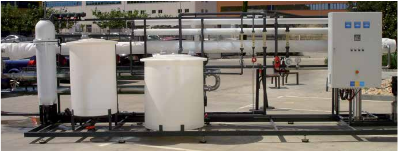
Planta de ósmosis de doble paso para producción de agua de alta calidad para lavado de automóviles.
