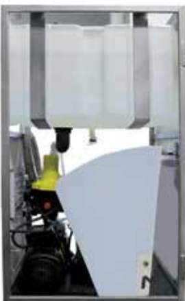
Vista lateral depósito acumulación y grupo de presión.
