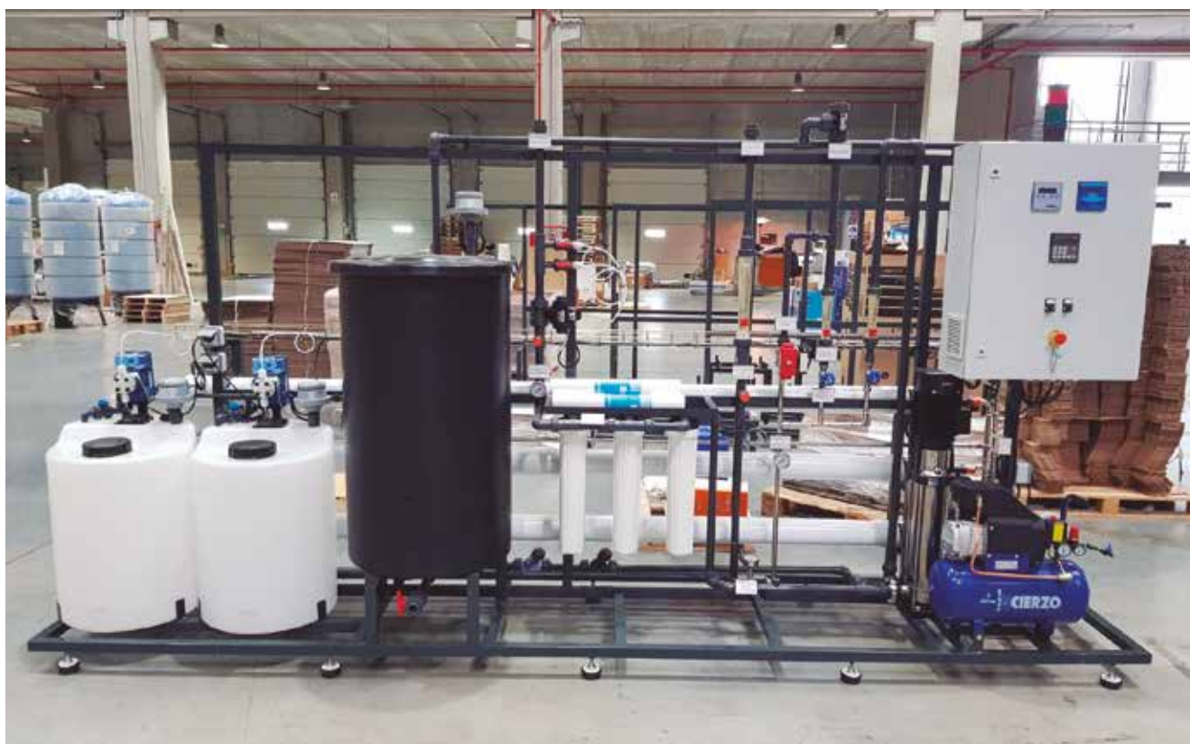
Planta de ósmosis inversa con una producción de 43 m 3 /d para la potabilización de agua de consumo en granja de pollos, instalada en Lérida.
