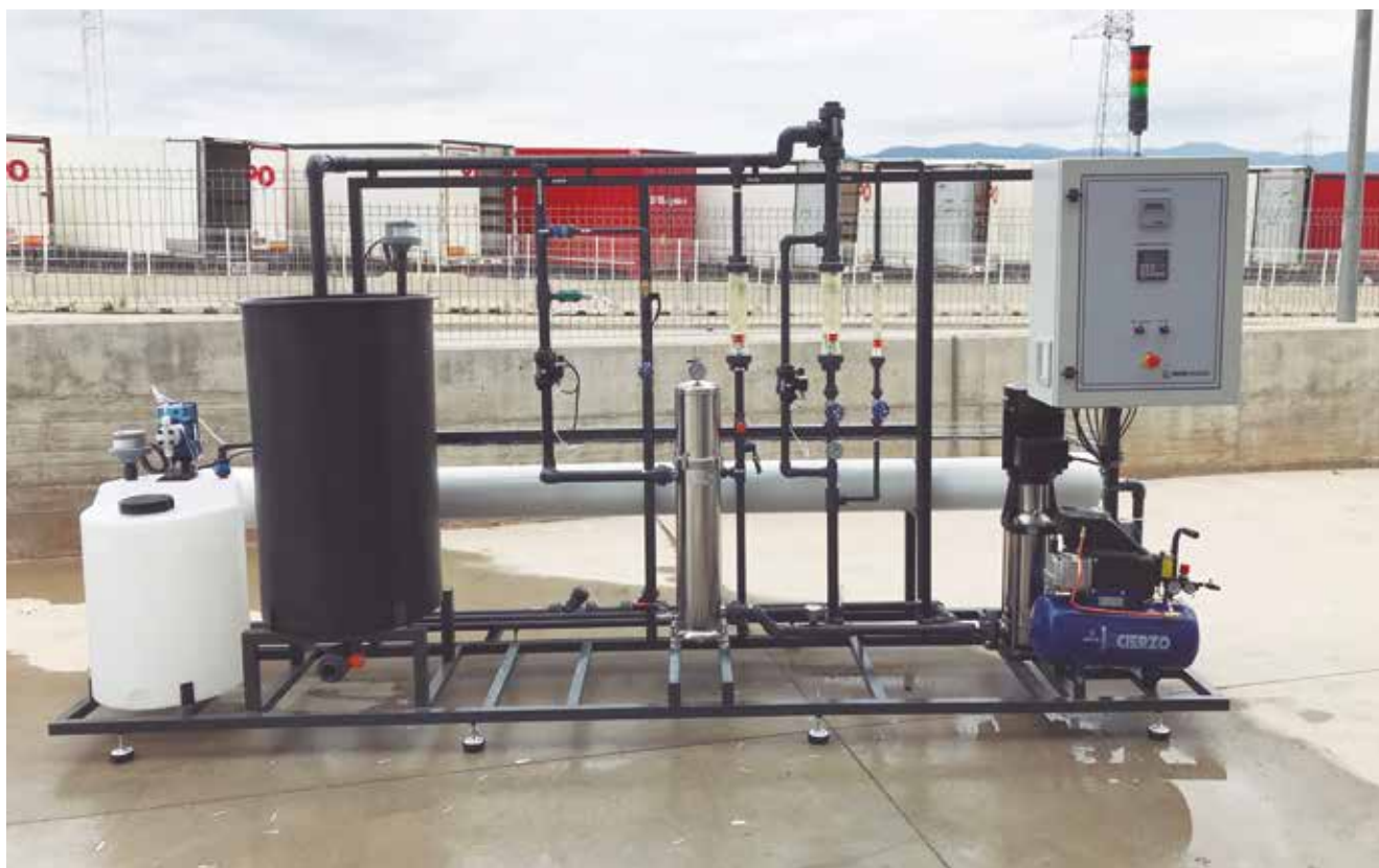
Planta de ósmosis inversa de 60 m 3 /d instalada en Argelia.
