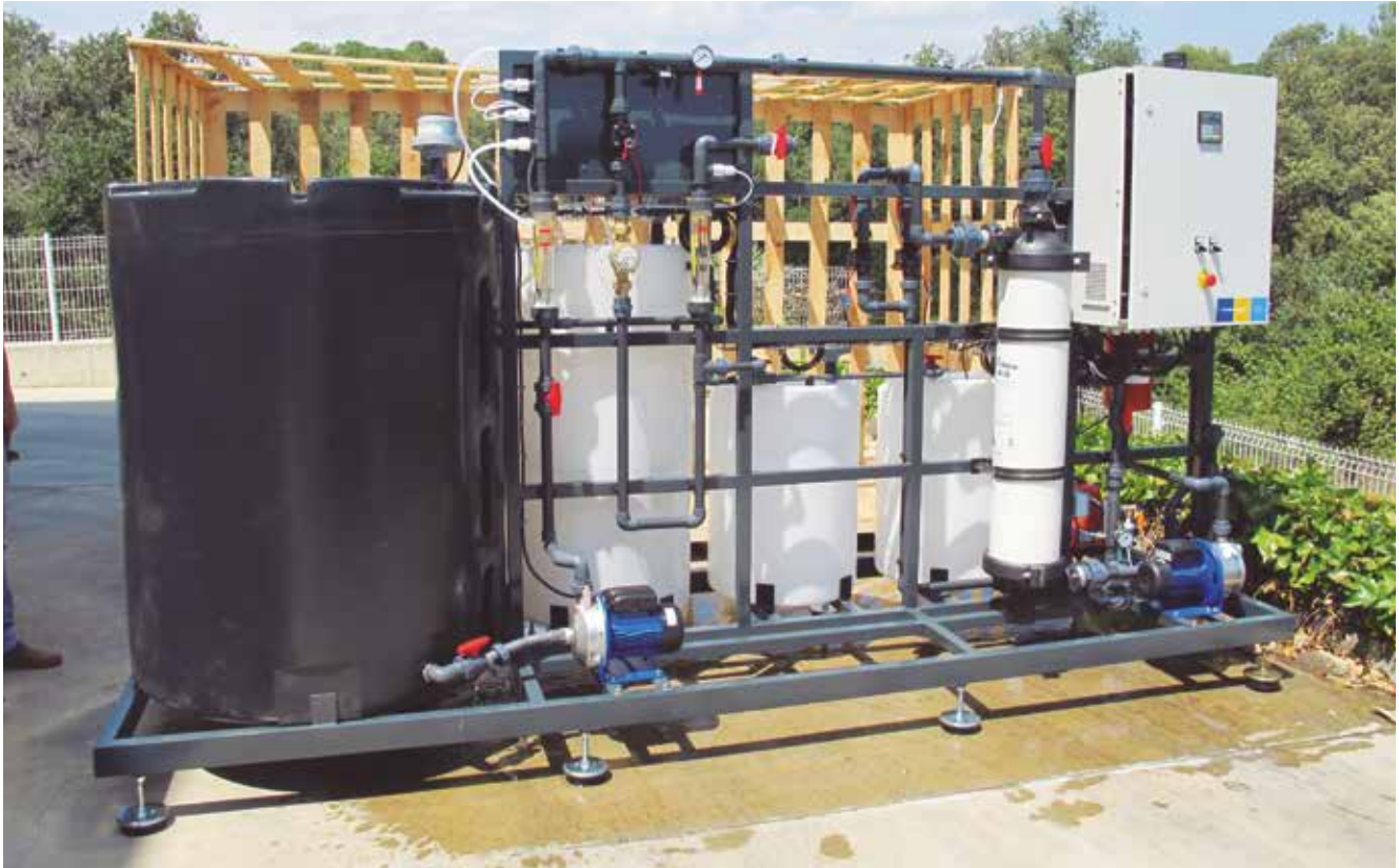
Planta de ultrafiltración de 4m 3 /h para la potabilización de agua de bebida, instalada en Uganda.
