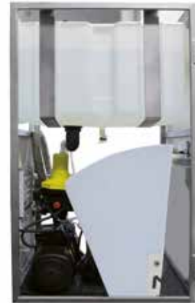
Vista lateral depósito acumulación y grupo de presión
