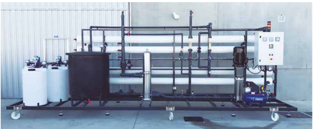
Planta de ósmosis inversa de 400 m 3 /día para un tratamiento de caldera de vapor, instalada en Relizane (Argelia).
