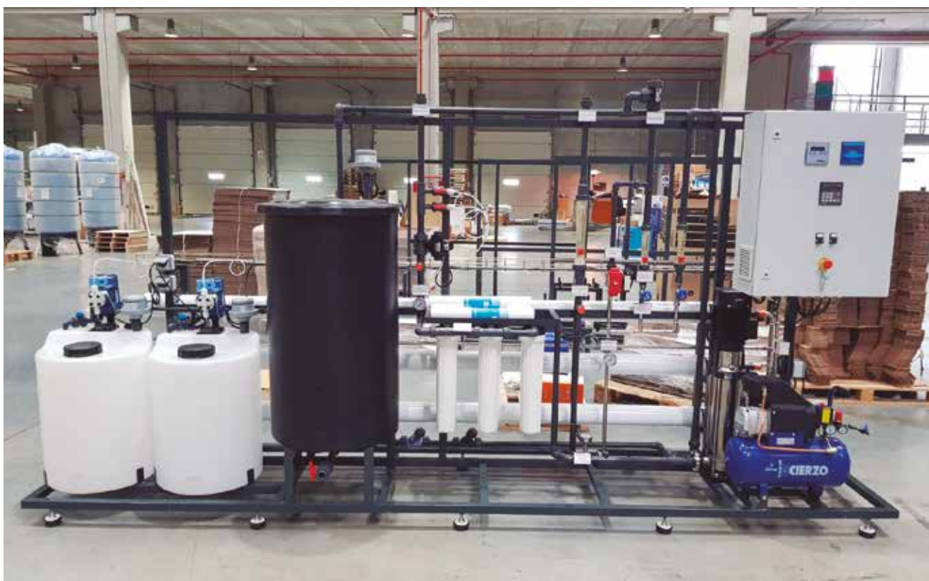
Planta de ósmosis inversa con una producción de 43 m 3 /d para la potabilización de agua de consumo en granja de pollos, instalada en Lérida.
